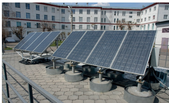
1-сурет – ФСМ-185Д екі жақты модульдері бар күн электр станциясының көрінісі
