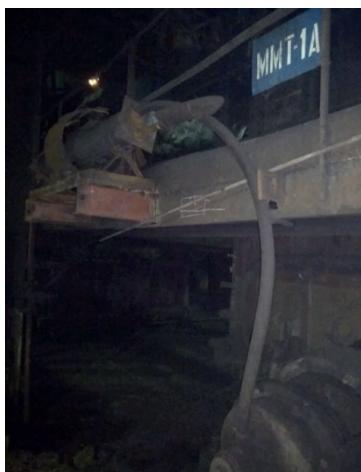
Рисунок 5 - Электрогидродинамический активатор воды, установленный в разрыв трубопровода системы мельницы котельного агрегата №5 ТЭЦ - 3
