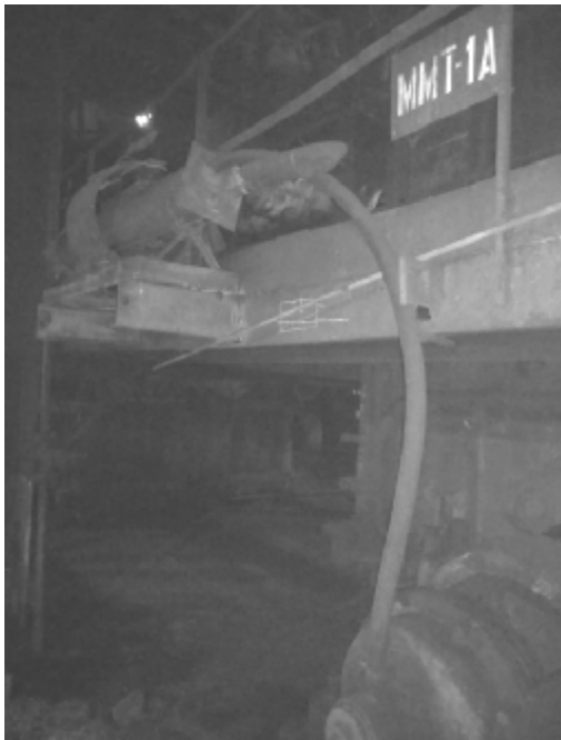
Рисунок 5 - Электрогидродинамический активатор воды, установленный в разрыв трубопровода системы мельницы котельного агрегата №5 ТЭЦ - 3
