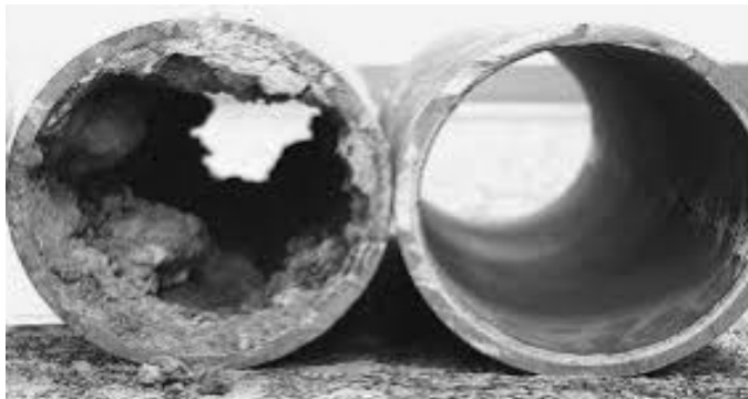
Рисунок 1 - Фрагмент трубопровода с отложениями и без них
