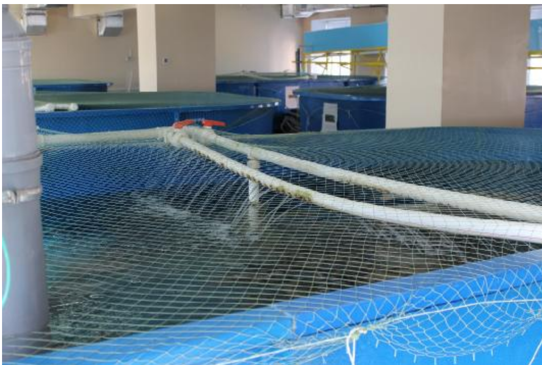
Рисунок 1 – Комплекс установок с замкнутым циклом водообеспечения
